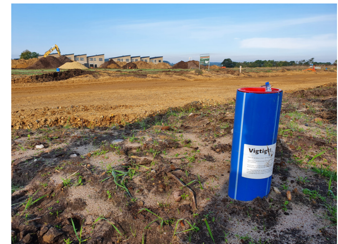
Temporärer Einlass auf einer neuen Baustelle mit einem im Deckel installierten Sensor.
