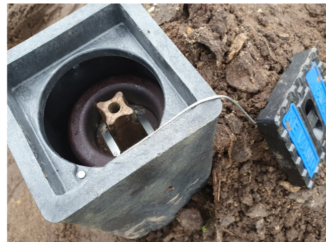
Der VIDI-Positioner ist in einer Kunststoff-Straßenkappe installiert.
