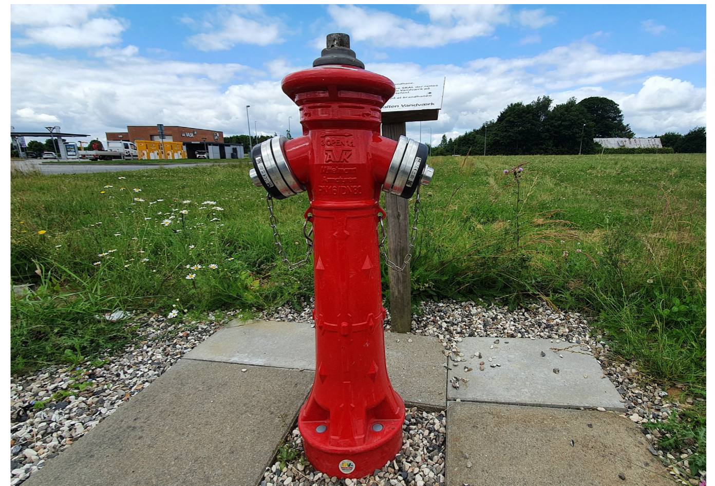
Hydrant mit installierten VIDI-Caps. Die Benutzung eines Hydranten hat große Auswirkungen auf den Wasserdruck im Versorgungsgebiet. Daher ist es für das Versorgungsunternehmen wichtig zu wissen, wann der Hydrant benutzt wird, um zu unterscheiden, ob der Druckabfall von einer normalen Benutzung oder von einem Rohrbruch herrührt.
