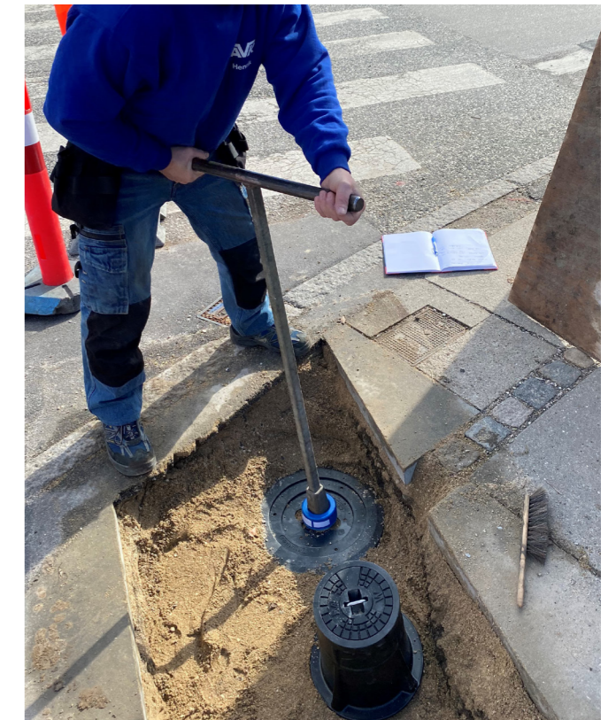
Erdeinbau Absperrschieber mit VIDI-Positioner, der die Betätigung des Absperrschiebers erkennt.
